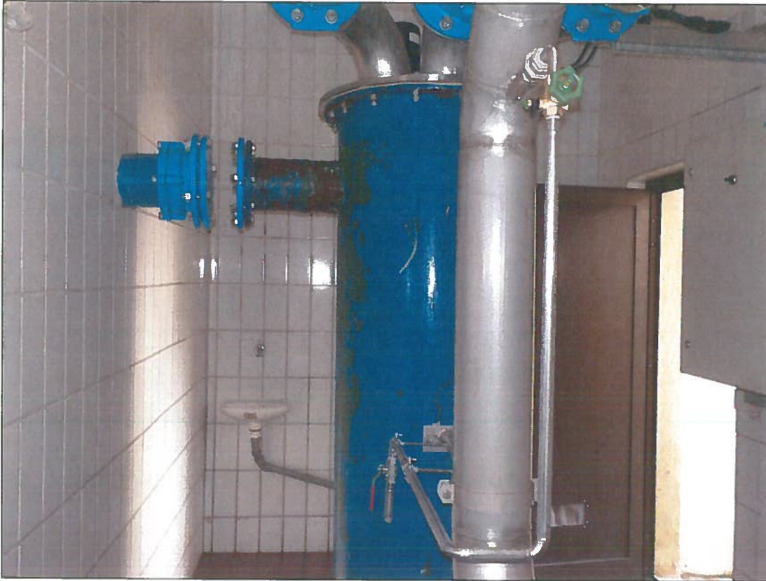
Abbildung 1: WVA Felixdorf –Sollenau, Brunnen 8a, neue Entnahmestelle für Wasserproben
